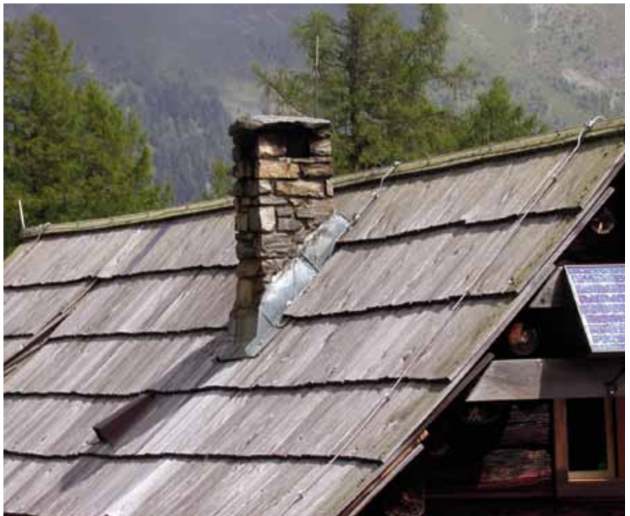
Blitzableitersysteme sollten auch bei Almhütten nicht fehlen.
