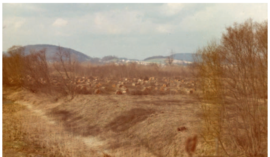
Abb. 6: Der Bauplatz für das Kraftwerk Abwinden-Asten wird eingerichtet, der Auwald in den frühen 1970er Jahren geschlägert. Im Hintergrund der Luftenberg.
